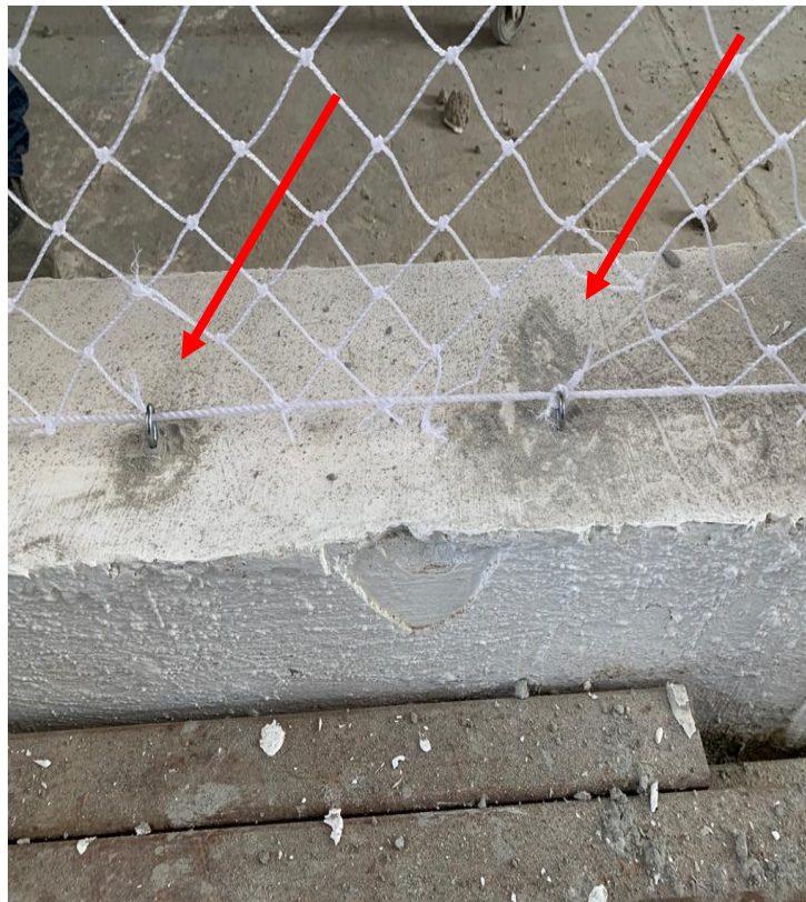
Foto n.º 02 – Visualização da ocorrência após o impacto de corpo mole
